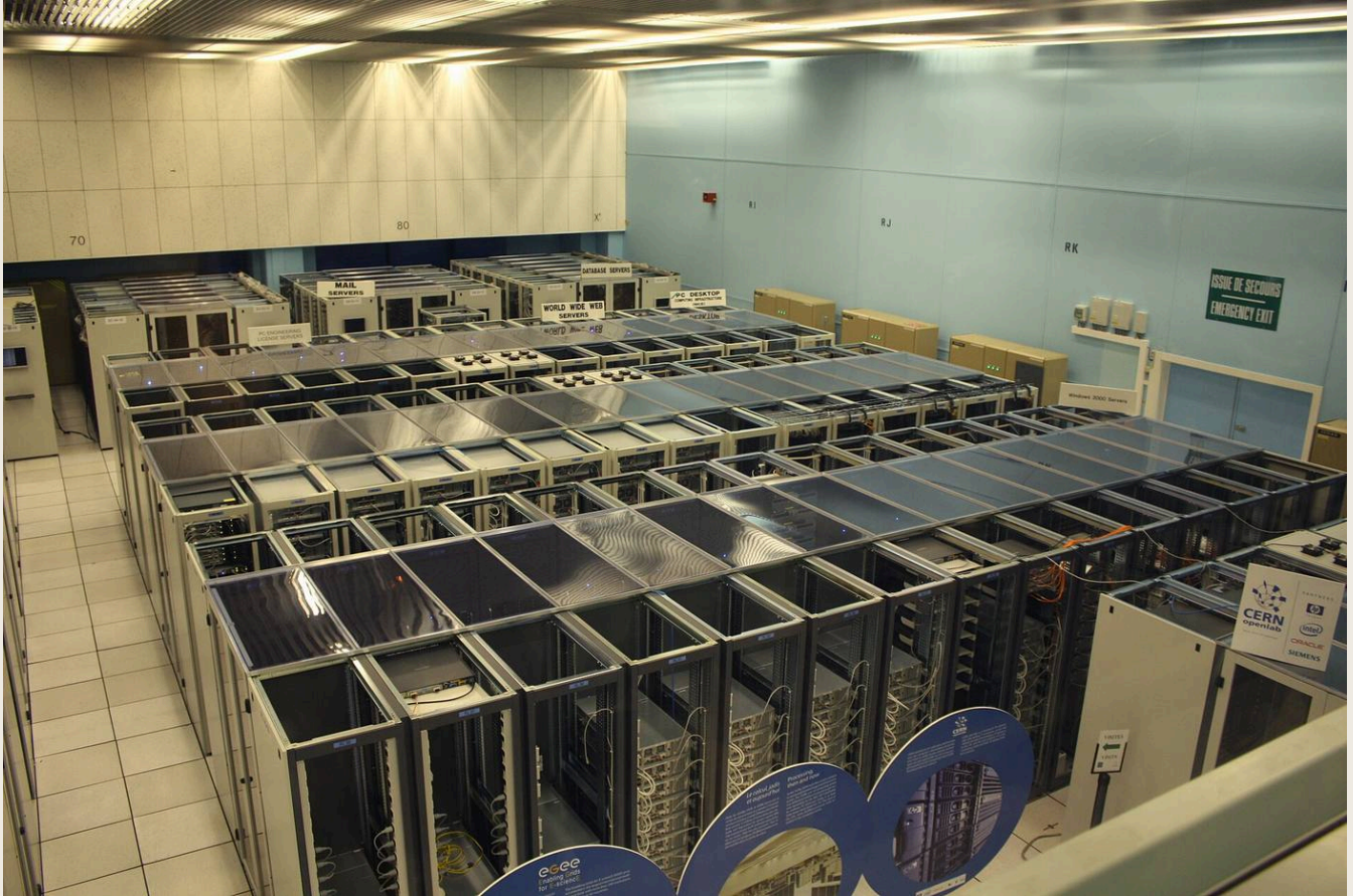
FIG. 02 · SERVER HALL, CERN · PHOTO: HUGOVANMEIJEREN / WIKIMEDIA COMMONS · CC BY-SA 3.0. Source and licence
