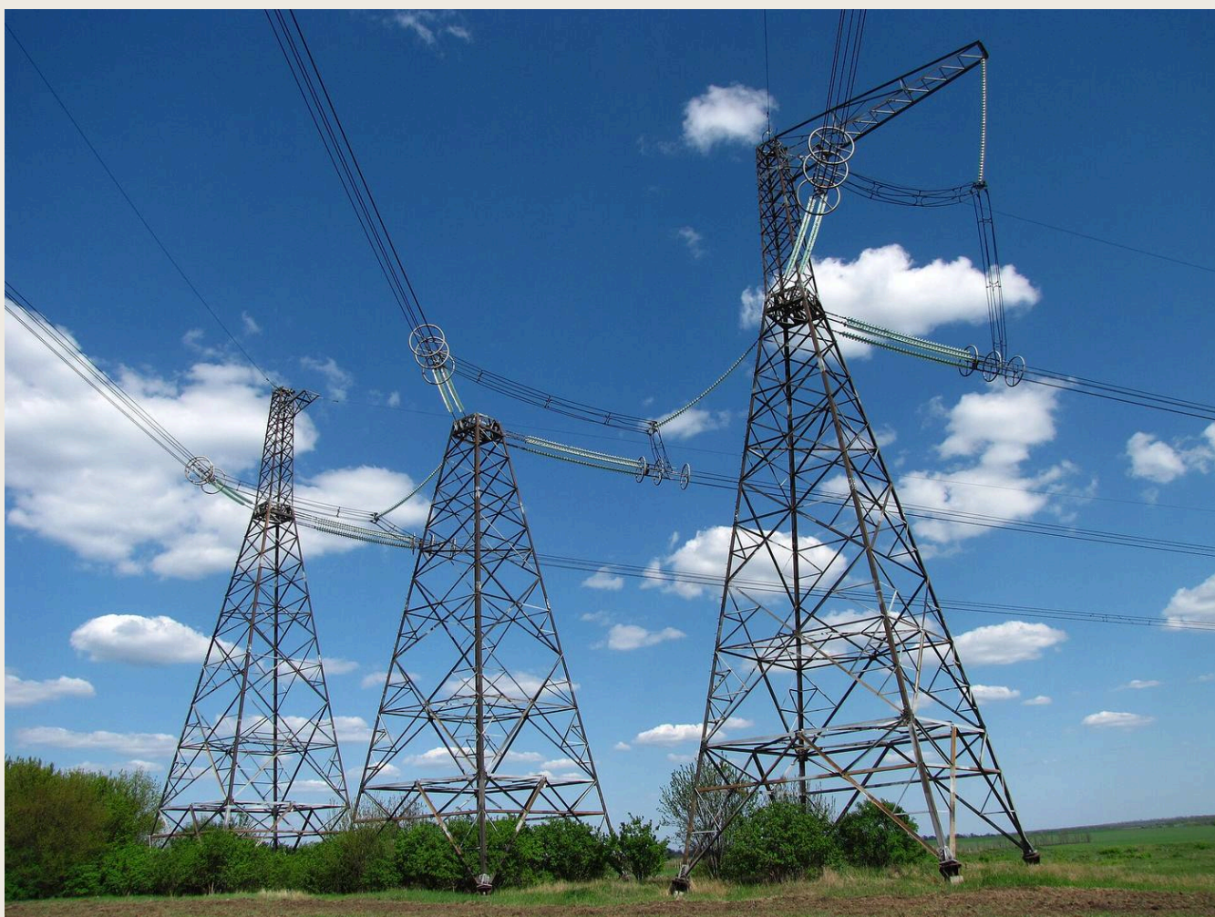
FIG. 12 · 750 KV HIGH-VOLTAGE PYLON · PHOTO: NOVOKLIMOV / WIKIMEDIA COMMONS · CC0. Source and licence
